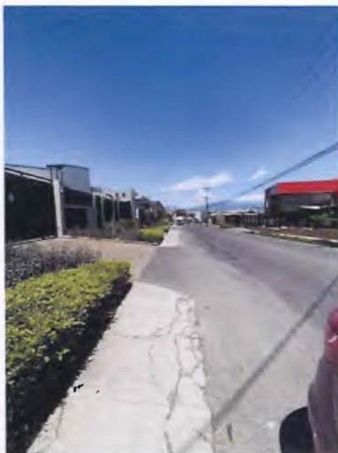
Imagen No. 4 Grupo de Seminario. Acera deteriorada sin cordón y caño, Condominio Casa Real, Distrito San Sebastián, Cantón de San José, Provincia de San José.
