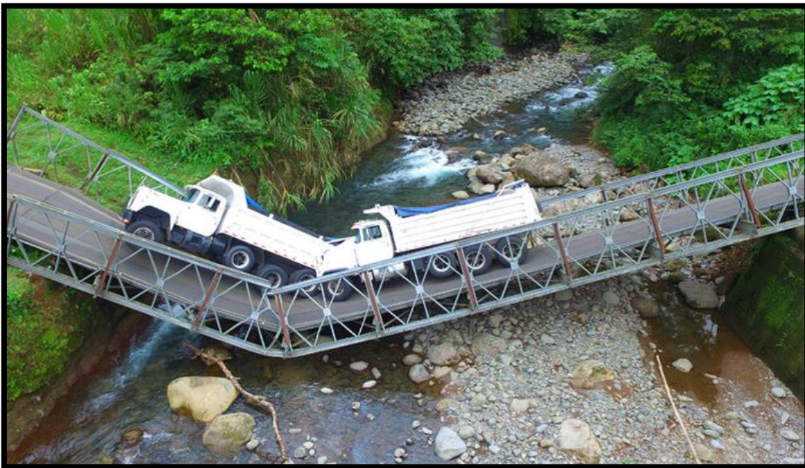
Figura 1-4. Colapso del puente Bailey sobre el río Cataratas Fuente: Diario La Nación, 20 nov 2015
