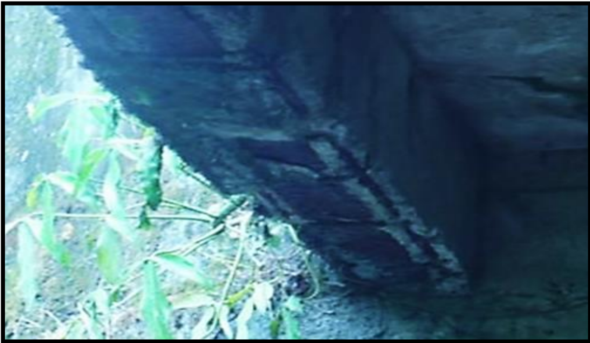
Figura 1-3. Puente sin mantenimiento en San Pedro Montes de Oca Fuente: LanammeUCR, 2011
