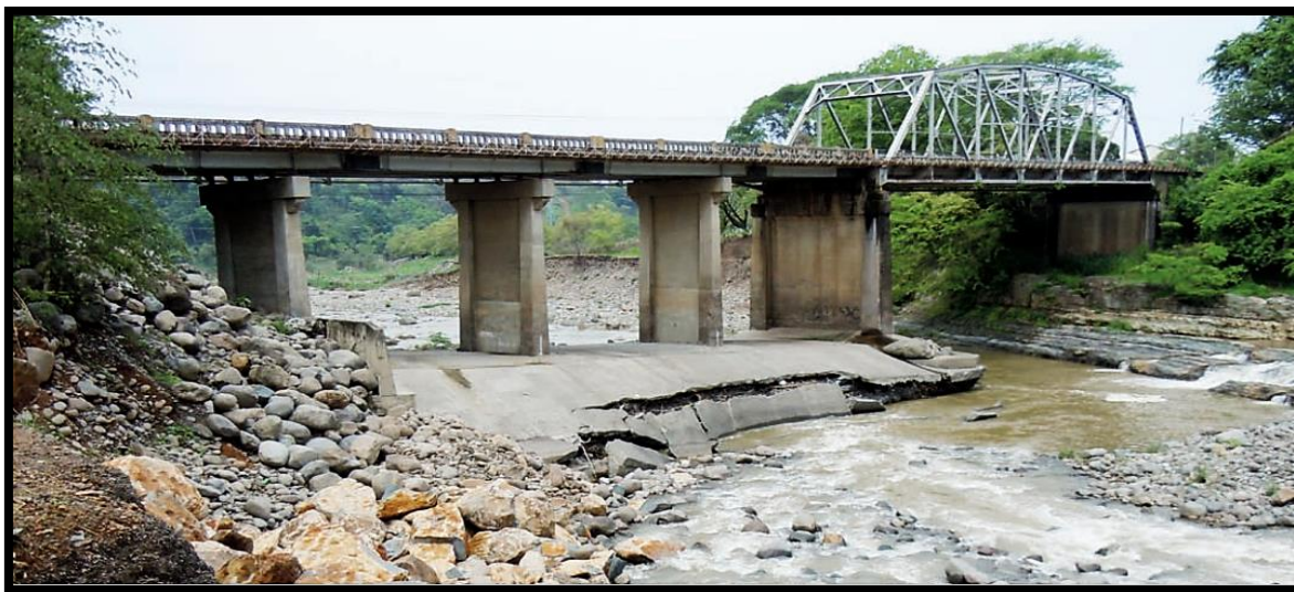
Figura 1-1. Puente en mal estado Fuente: Castillo, R.; 2011
