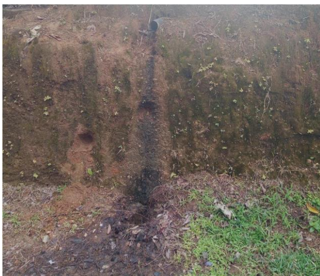
Figura 45. Muestra de vertido de aguas grises directo a la calle, malos olores, daño a la vegetación cercana y al paisaje. Foto tomada en Agujitas centro
