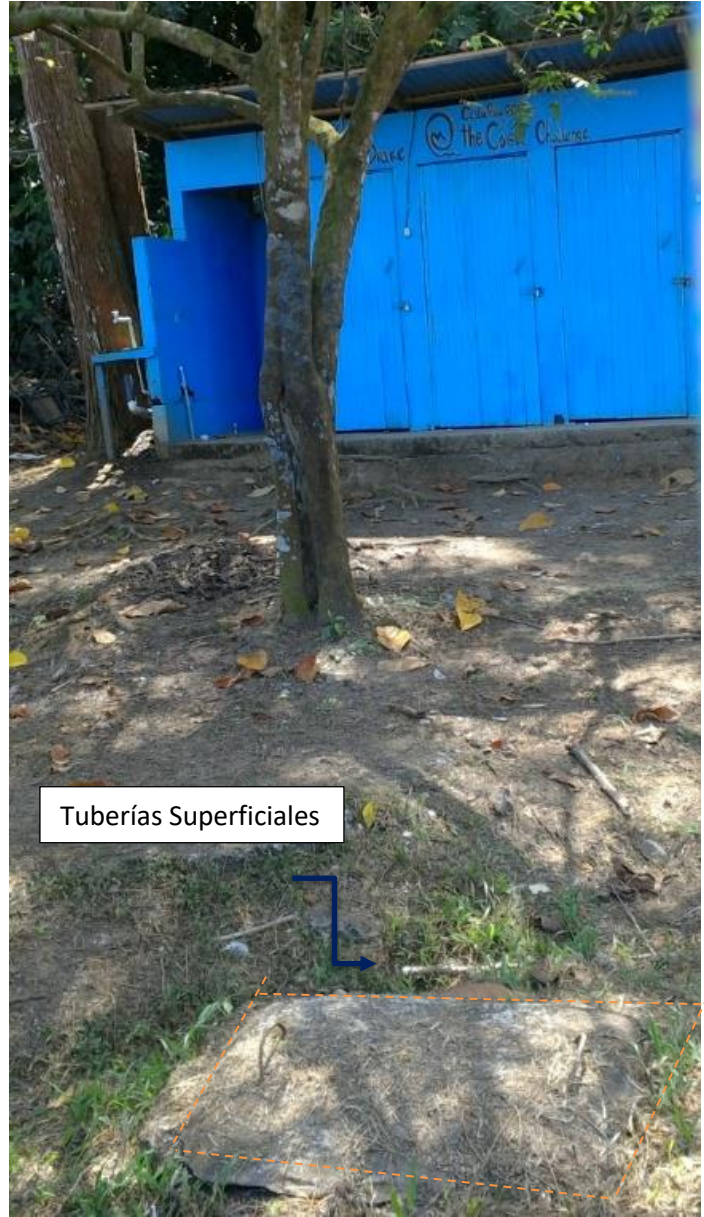
Figura 39. Tuberías superficiales hacia tapa de Tanque séptico en zona de baños públicos
