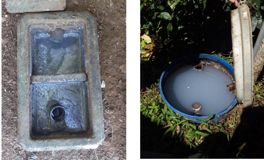
Figura 3. Trampa de grasas (izquierda) y tanque de pretratamiento (derecha), Biojardinera Zapote, San Mateo.
