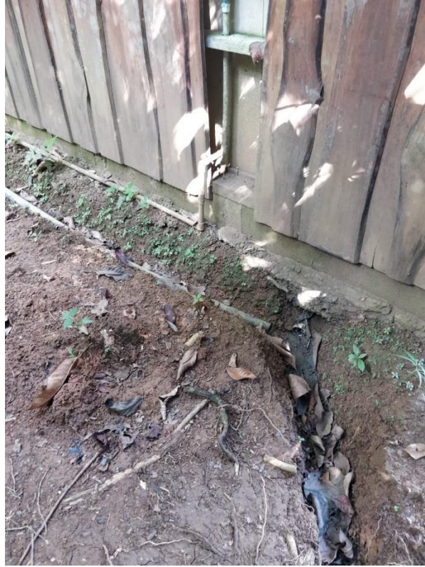
Figura 41. Tuberías de aguas grises que desembocan en el terreno de forma superficial.
