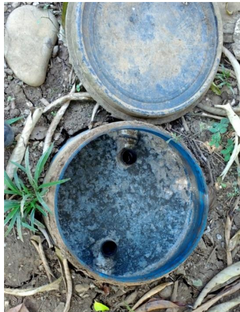
Figura 37. Tanques sedimentadores con grasa
