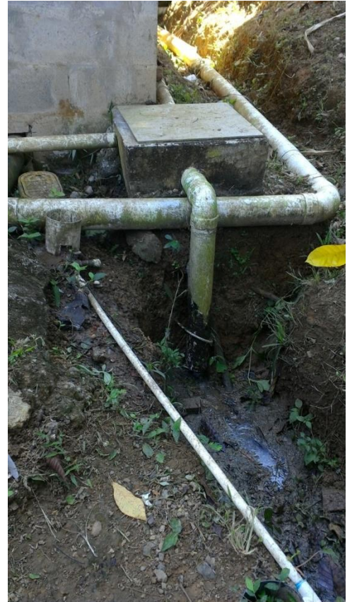
Figura 43. Tuberías de aguas grises que desembocan en el terreno de forma superficial. Evidencia de estancamiento de las aguas y contaminación. Además de cercanía con tuberías potables.
