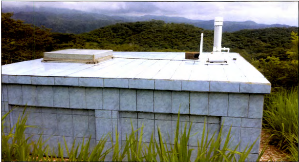
Figura III.40. Tanque de concreto de la comunidad de Tres Amigos
