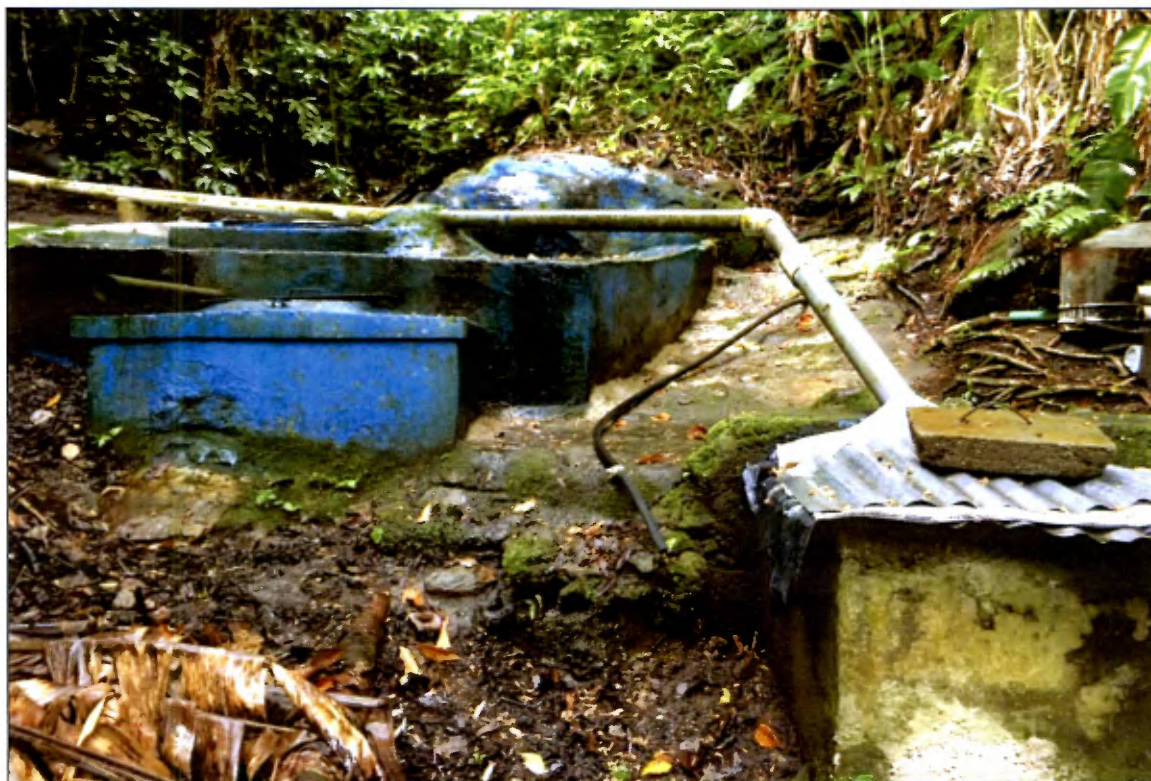
Figura III.50. Captación de San Rafael
