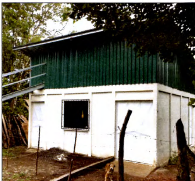
Figura V.85. Oficina y bodega de la ASADA de Candelaria y Campos de Oro
