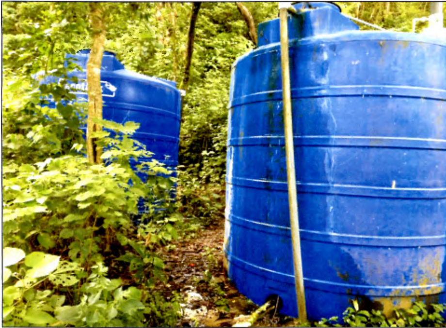
Figura III.39. Tanques de plástico de la comunidad de Tres Amigos
