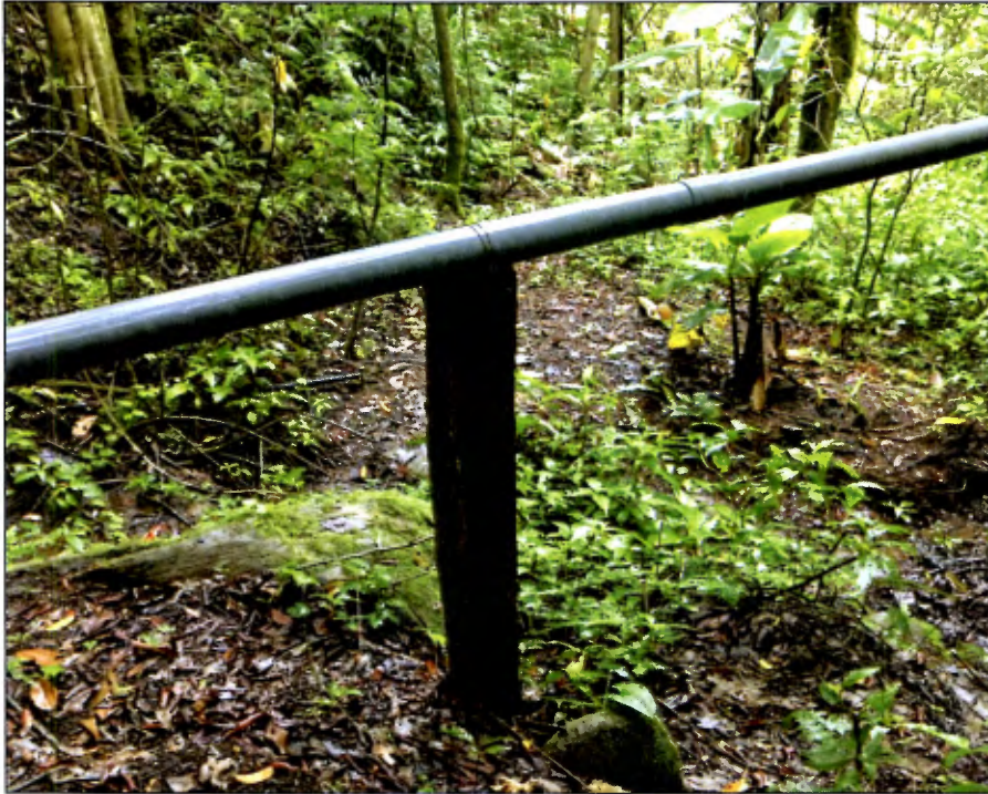
Figura III.52. Tubería descubierta de San Rafael
