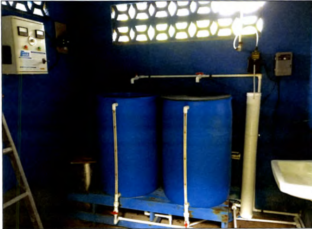
Figura III.64. Sistema de desinfección del agua de La Cruz
