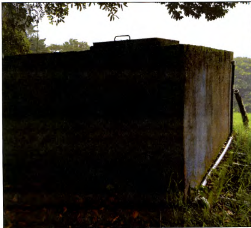
Figura III.62. Tanque de almacenamiento de concreto de emergencia de La Cruz
