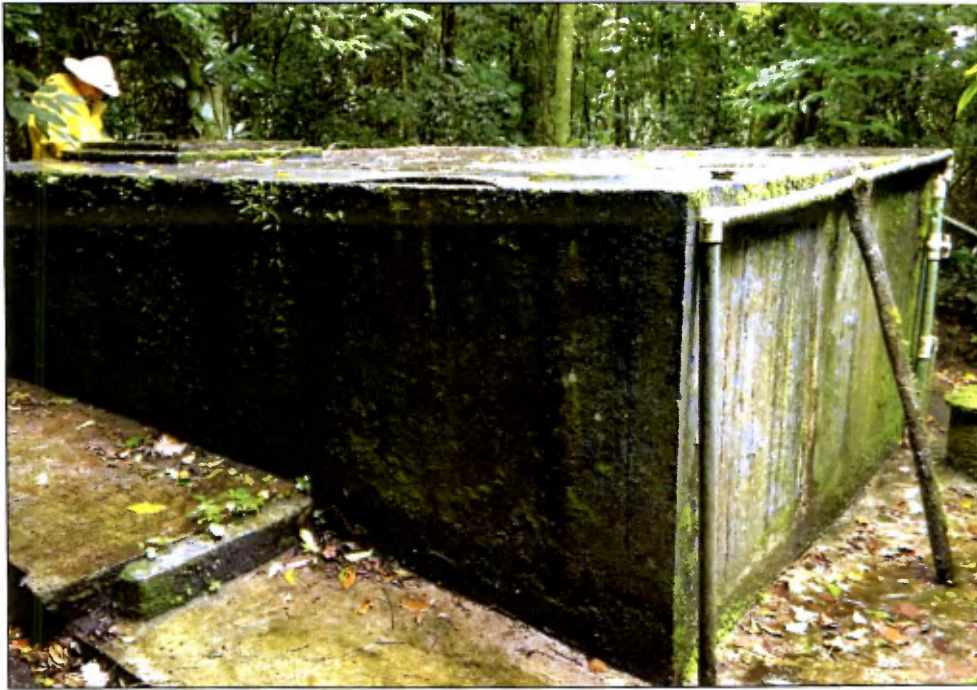
Figura III.61. Tanque de almacenamiento de concreto principal de La Cruz
