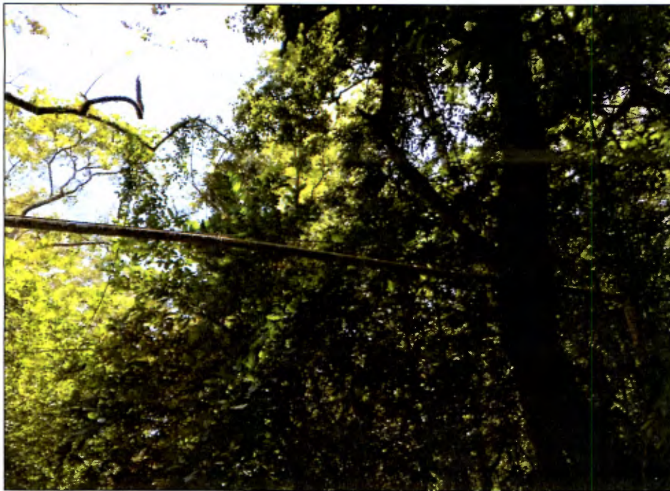
Figura III.38. Tubería descubierta de Tres Amigos
