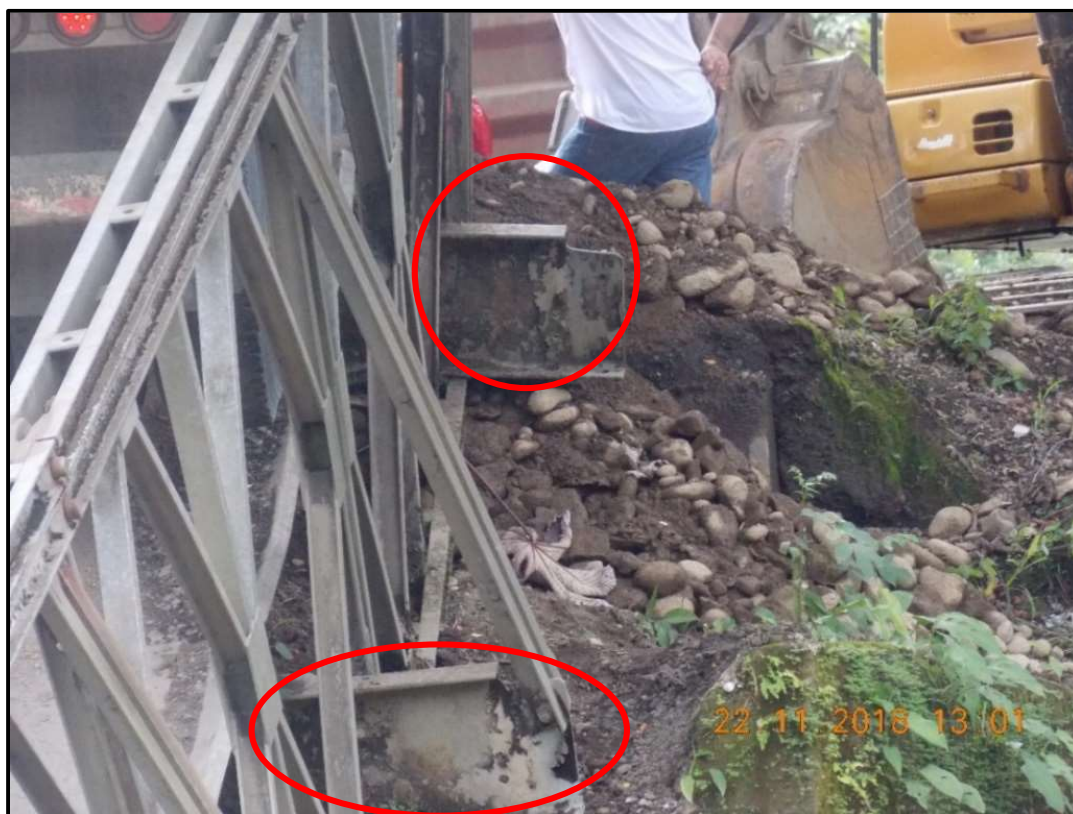
Figura 20. Deterioro de la estructura del Río Balsa – Santa Clara Fuente: (LanammeUCR, 2018)
