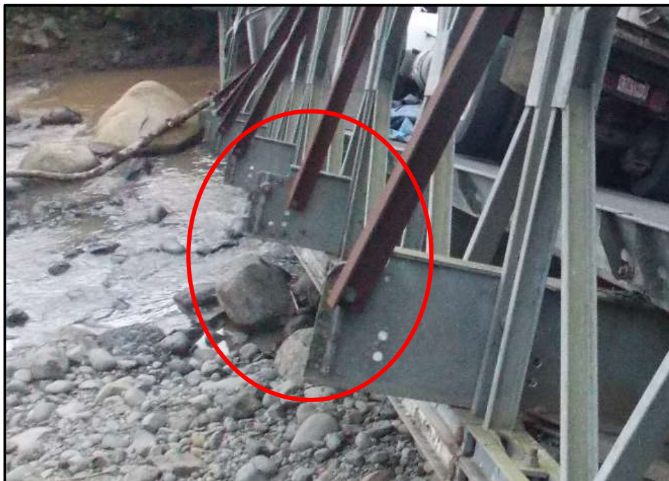
Figura 33. Distinta conexión de las riostras exteriores del puente sobre el Río Cataratas Fuente: (LanammeUCR, 2015)
