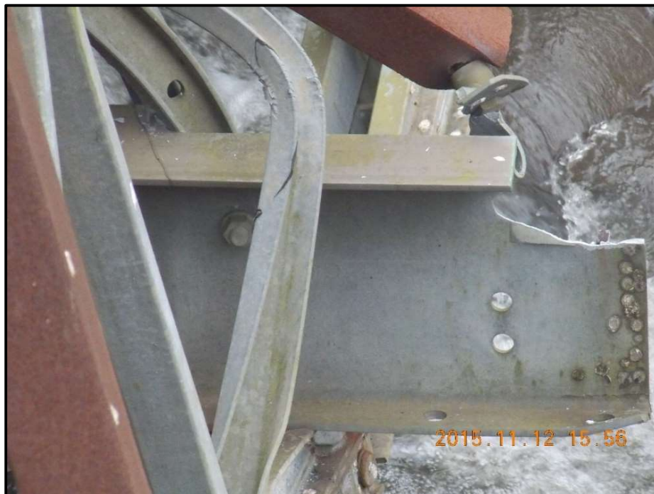
Figura 31. Acercamiento de la fractura de la viga travesaño, puente sobre Río Cataratas Fuente: (LanammeUCRUCR, 2015)
