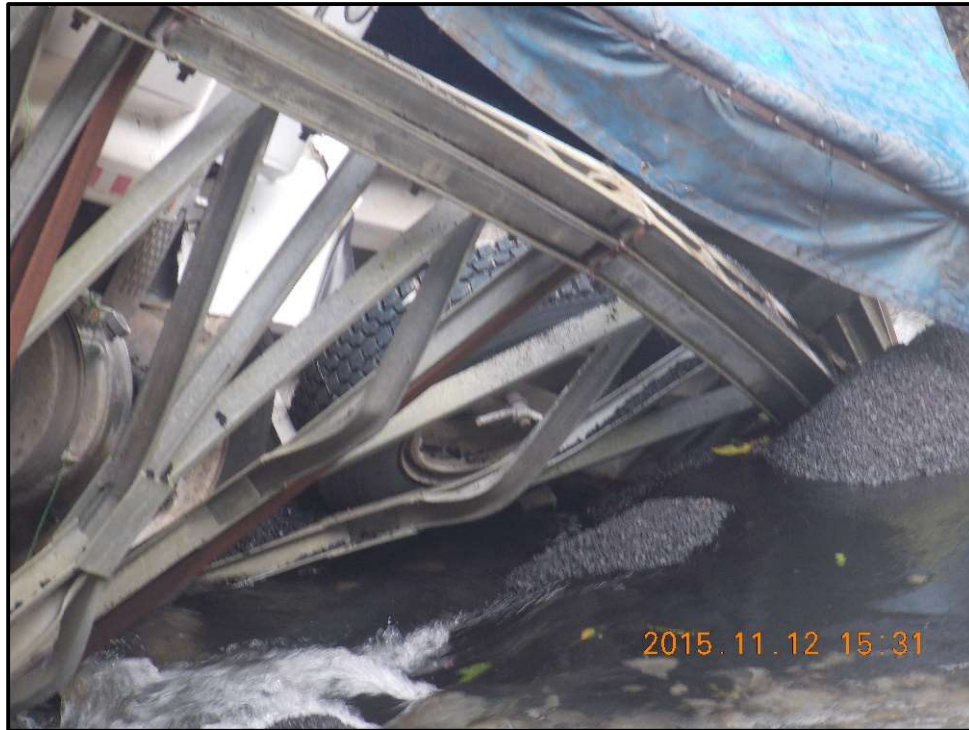
Figura 30. Pandeo de las riostras exteriores por compresión del puente sobre el Río Cataratas Fuente: (LanammeUCR, 2015)
