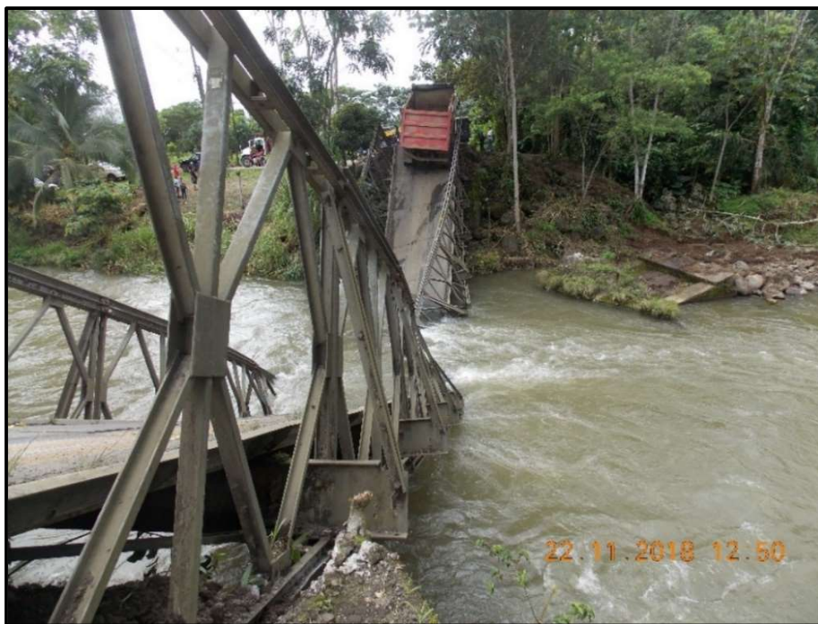
Figura 16. Vista general del modo de pandeo del puente sobre Río Balsa – Santa Clara. Tomada desde el lado exterior de las cerchas
