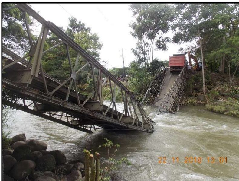
Figura 1. Colapso del puente sobre Río Balsa Fuente: (LanammaUCR, 2018)
