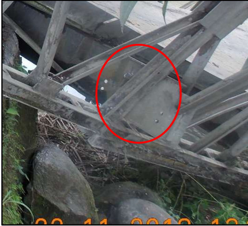
Figura 23. Ubicación final de viga travesaño del puente sobre el Río Balsa-Santa Clara Fuente: (LanammeJCR, 2018)
