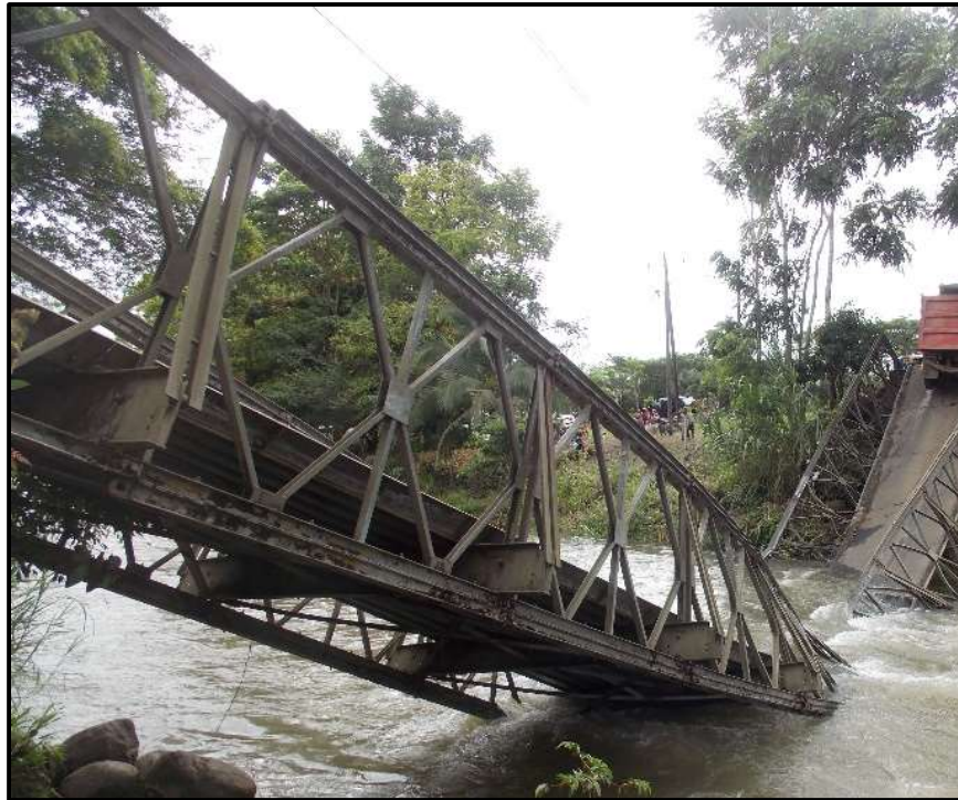
Figura 60. Riostra exterior: Puente Río Balsa – Santa Clara Fuente: (LanammeUCR, 2018)
