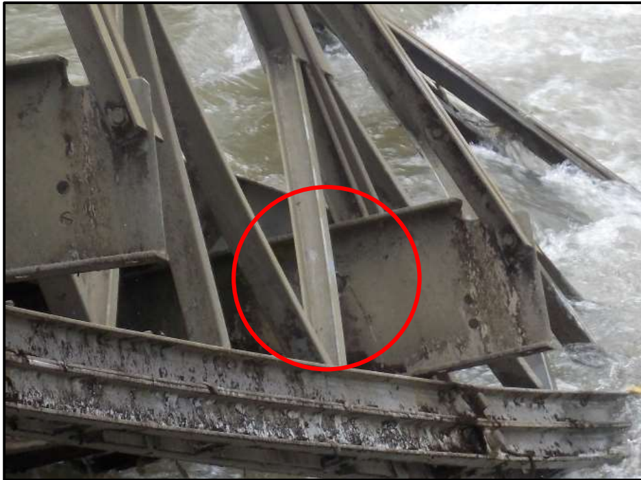
Figura 21. Desplazamiento de la viga travesaño del puente sobre el Río Balsa-Santa Clara Fuente: (LanammeUCR, 2018)
