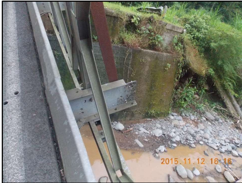
Figura 34. Deterioro de la estructura del puente sobre el Río Cataratas Fuente: (LanammeUCR, 2015)
