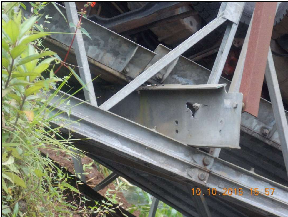
Figura 32. Agujero generado en la viga travesaño, puente sobre el Río Cataratas Fuente: (LanammeUCR, 2015)
