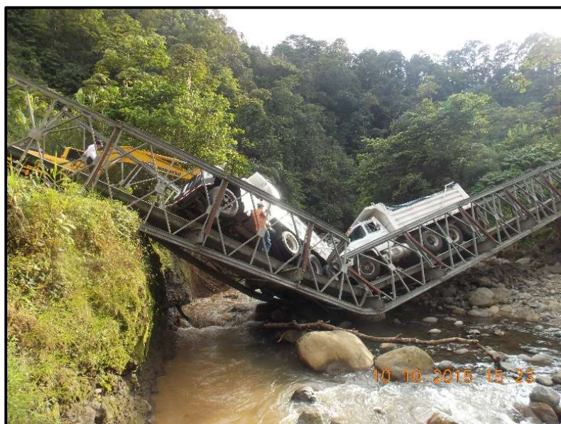
Figura 2. Colapso sobre el Río Cataratas Fuente: (LanammaUCR, 2015)
