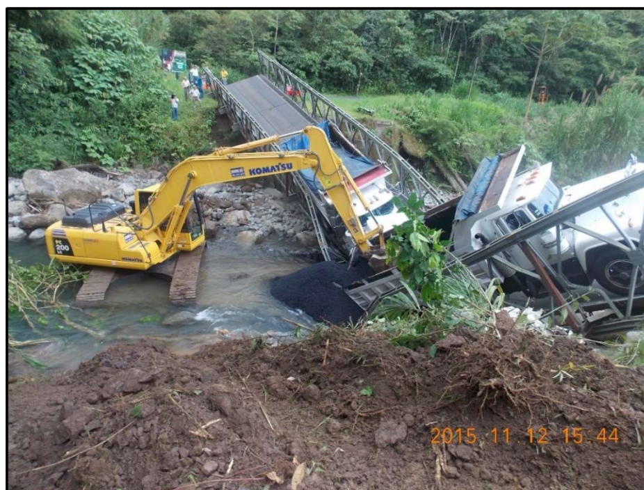
Figura 43. Asfalto que cargaban los vehículos al momento del colapso. Río Cataratas Fuente: (LanammeUCR, 2015)
