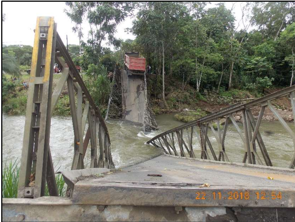
Figura 84. Pandeo global del puente sobre el Río Balsa-Santa Clara Fuente: (LanammeUCR, 2018)
