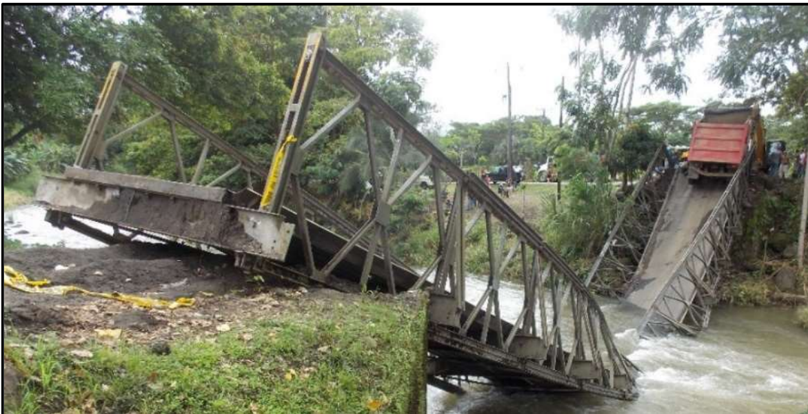
Figura 19. Vista general del modo de pandeo y levantamiento de fundaciones del puente sobre Río Balsa – Santa Clara. Tomada desde la superficie de rodamiento Fuente: (LanammeUCR, 2018)
