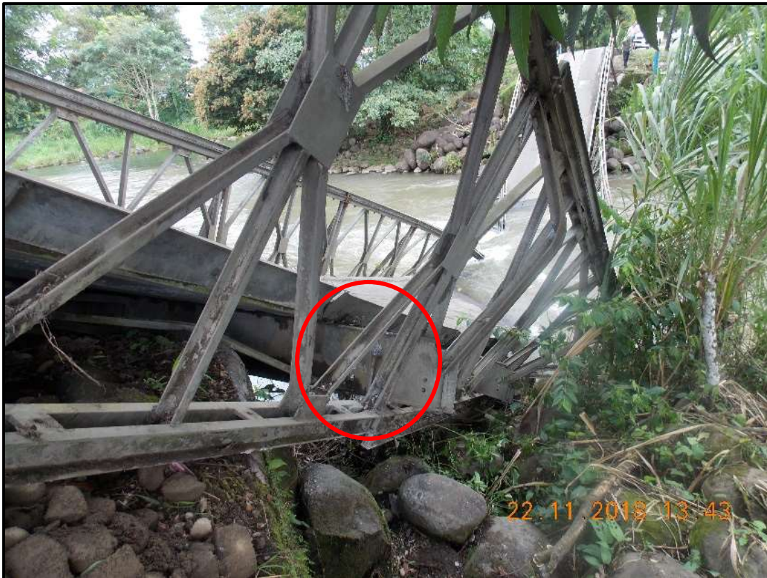
Figura 83. Desplazamiento de la viga travesaño respecto a la cuerda inferior Fuente: (LanammeUCR, 2018)
