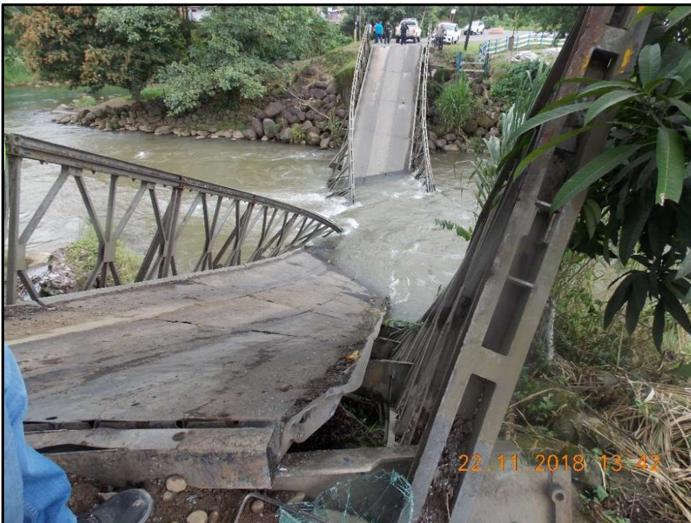
Figura 85. Pandeo global del puente sobre el Río Balsa-Santa Clara desde el extremo opuesto Fuente: (LanammeUCR, 2018)
