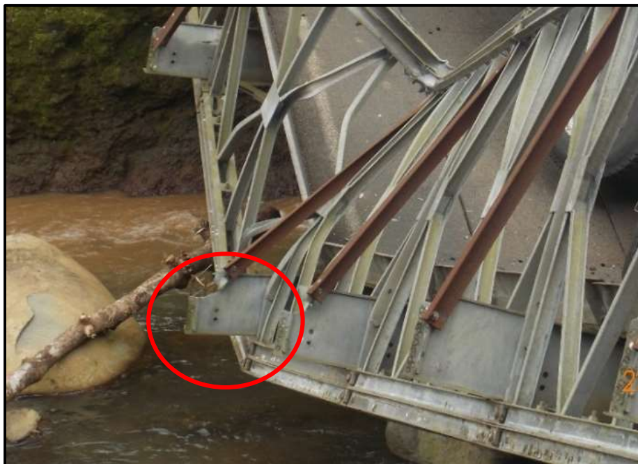
Figura 29. Fractura de la viga travesaño en conexión con la riostra exterior, puente sobre el Río Cataratas Fuente: (LanammeUCR, 2015)
