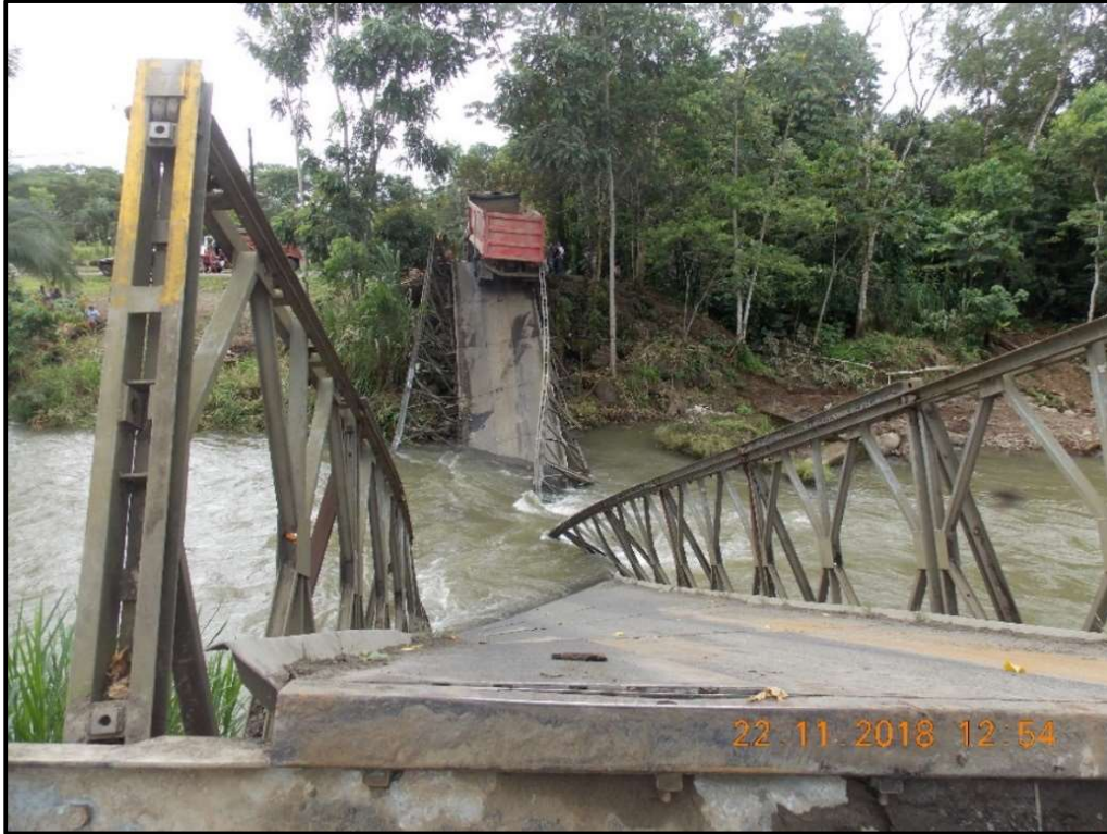
Figura 17. Vista general del modo de pandeo del puente sobre Río Balsa – Santa Clara. Tomada desde la superficie de rodamiento Fuente: (LanammeUCR, 2018)
