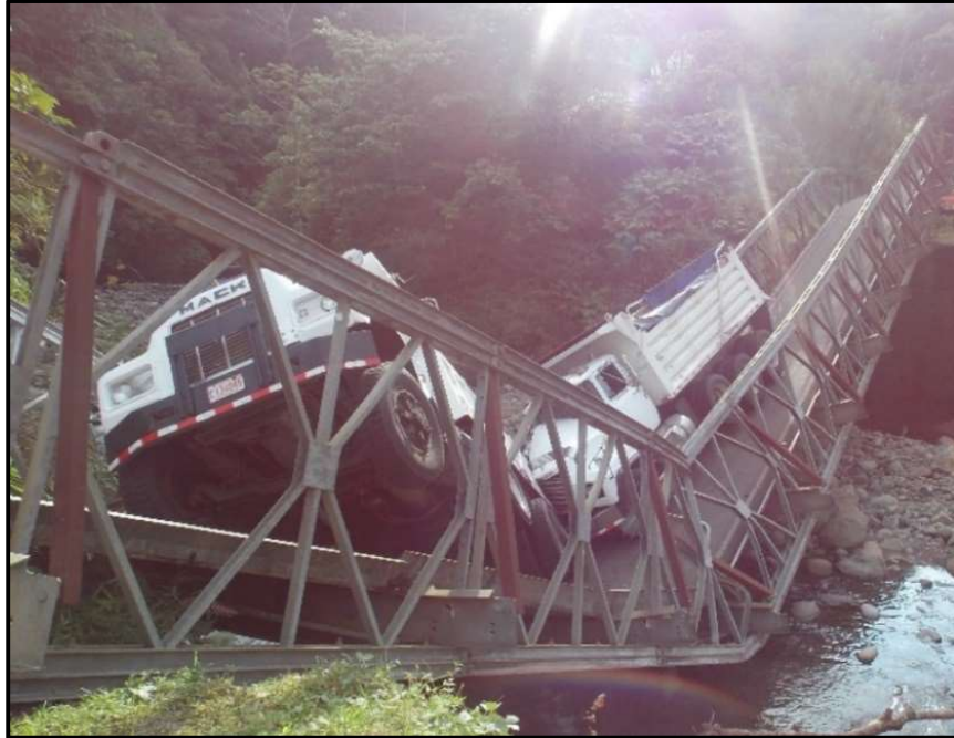
Figura 26. Vista general del modo de falla del puente sobre Río Cataratas. Vista lateral Fuente: (LanammeUCR, 2015)
