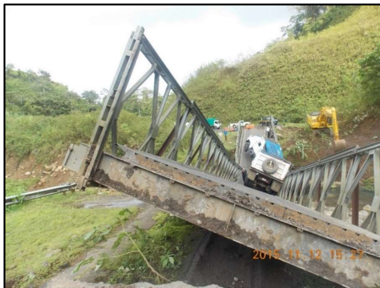
Figura 25. Vista transversal del levantamiento del extremo del puente sobre el Río Cataratas Fuente: (LanammeUCR, 2015)
