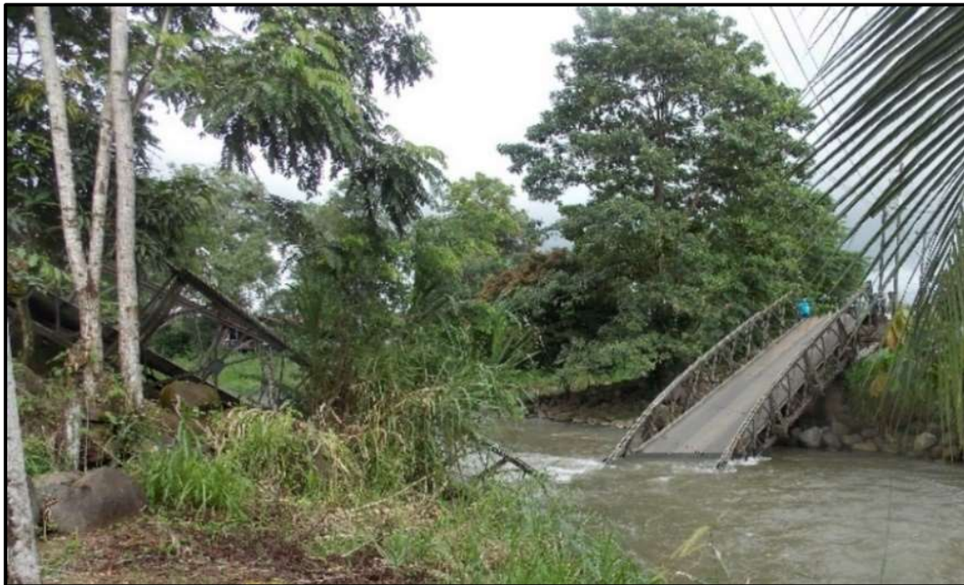
Figura 18. Vista general del modo de pandeo del puente sobre Río Balsa– Santa Clara. Tomada desde un costado Fuente: (LanammeUCR, 2018)
