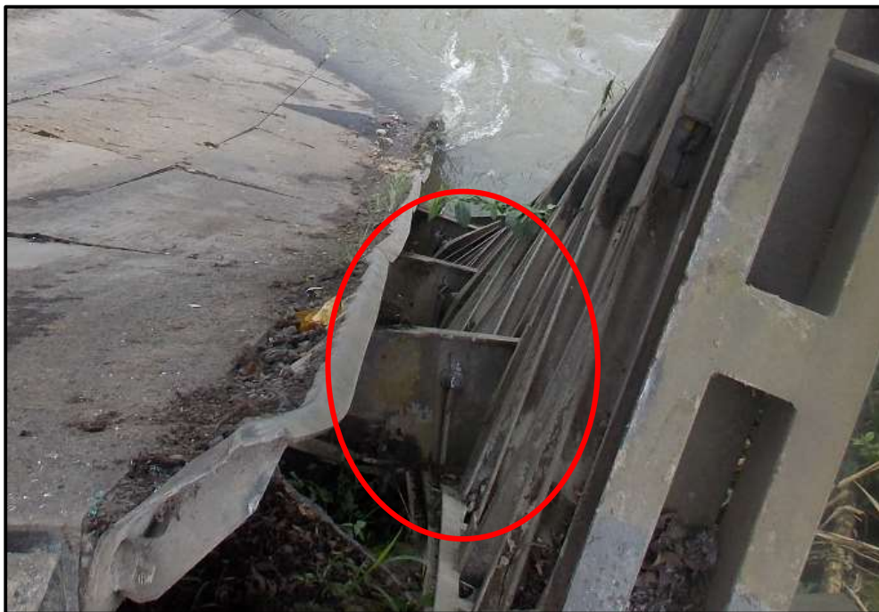
Figura 22. Desplazamiento de vertical respecto a viga travesaño del puente sobre el Río Balsa-Santa Clara Fuente: (LanammeUCR, 2018)
