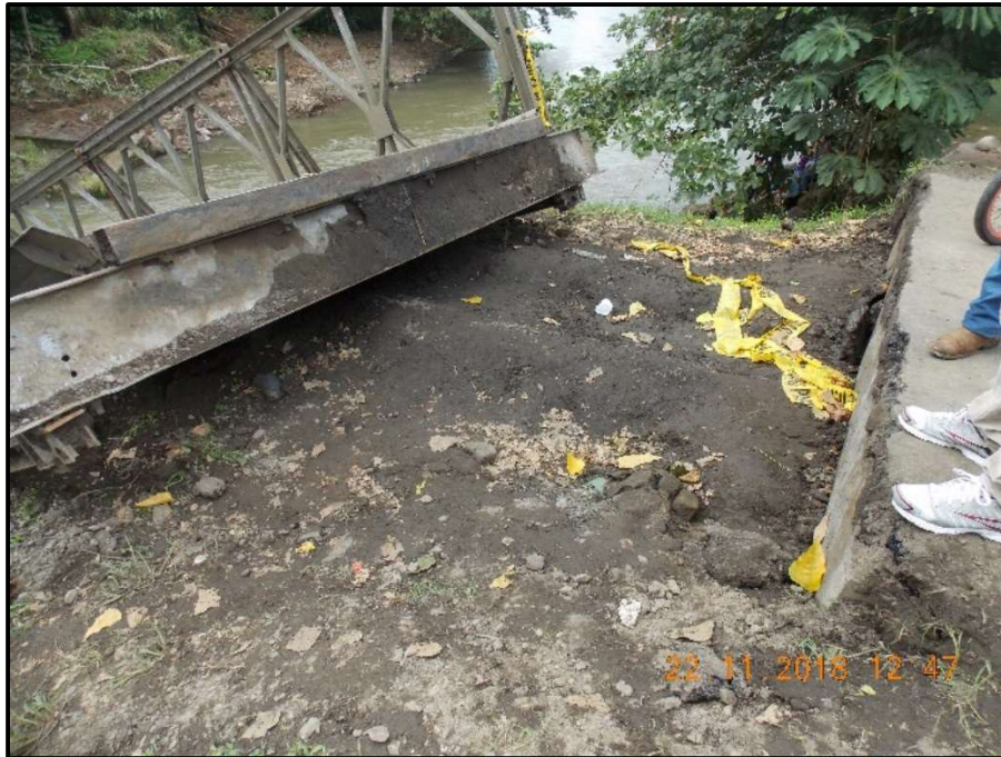
Figura 15. Sección de estructura del puente sobre el Río Balsa-Santa Clara que se apoya sobre el terreno.
