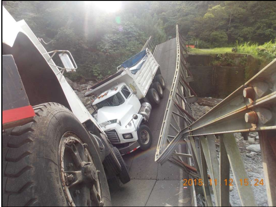
Figura 28. Falla local de la cuerda superior del puente sobre el Río Cataratas Fuente: (LanammeUCR, 2015)
