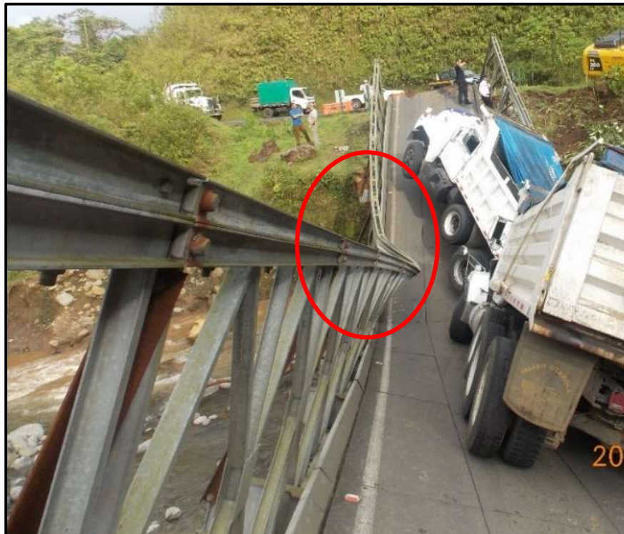
Figura 27. Vista general del modo de falla del puente sobre el Río Cataratas. Visto desde lo interno del puente Fuente: (LanammeUCR, 2015)
